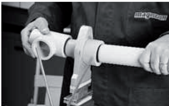
Obr.č.7: Ak kontrolou teploty nahrievacieho telesa bolo zistené, že skutočná hodnota teploty nahrievacieho telesa zodpovedá predpísaným hodnotám, rúru treba zasunúť - po značku - do nahrievacieho puzdra a tvarovku vložiť do nahrievacieho nátrubku podľa hodnôt tab.č.2. Počas doby nahrievania obidva súčiastky treba fixovať rukou bez tlaku.
